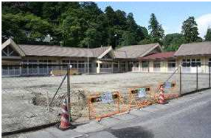
遊具撤去が済み、車両進入路の工事が進む跡地 (7月21日撮影)
